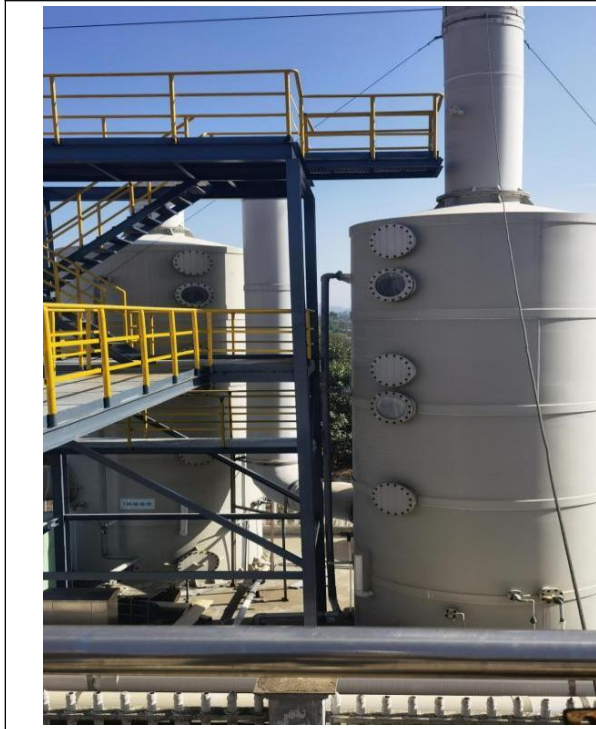
废气处理装置
